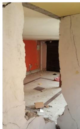
e) Daños en mampostería,
