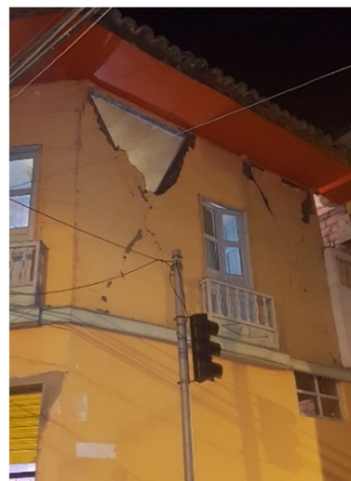
b) Daños en viviendas, cantón Chimbo.
