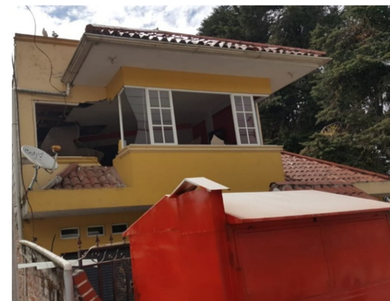
f) Daños en ventanales y fisuras, Chimborazo.
