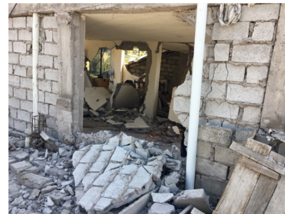
c) Colapso de paredes.
