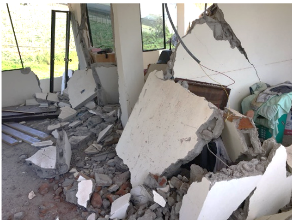
a) Daño severo en mampostería
